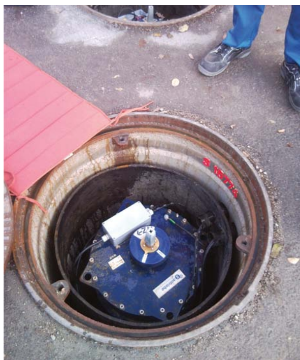
Bild 2: 3S Antriebe zur Automatisierung von Havariearmaturen im Wärmenetz
