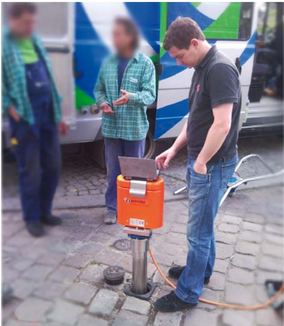
Bild 3: Betätigen einer Armatur mit dem „System Berliner Kappe“
